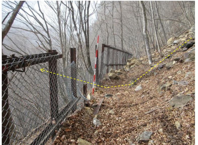
防護柵支柱の折損
