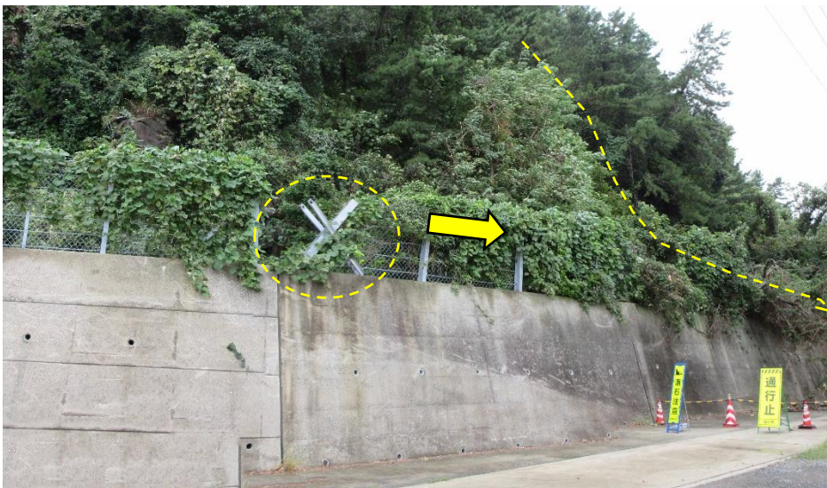
防護柵端末支柱の破損
