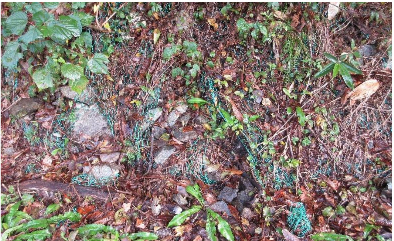
○金網 (φ1.6mm?) の耐久性・・・道路法面脚部の落石防止用
