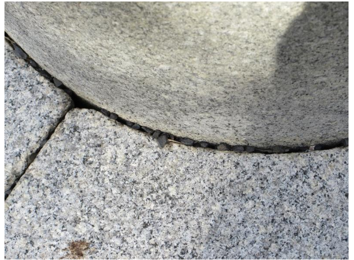
同左，柱脚部の沓石との隙間 (コンクリート等で固めない伝統構法・・・耐震)
