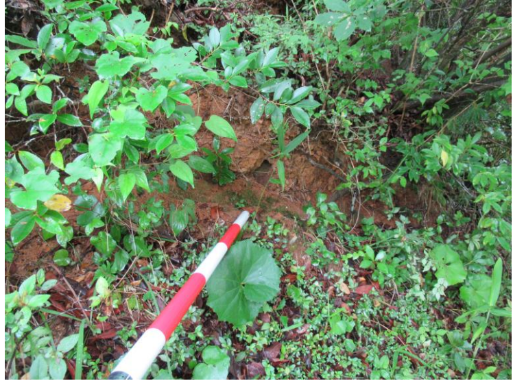
④ 右岸側中央付近の孕み（写真②の円内）
