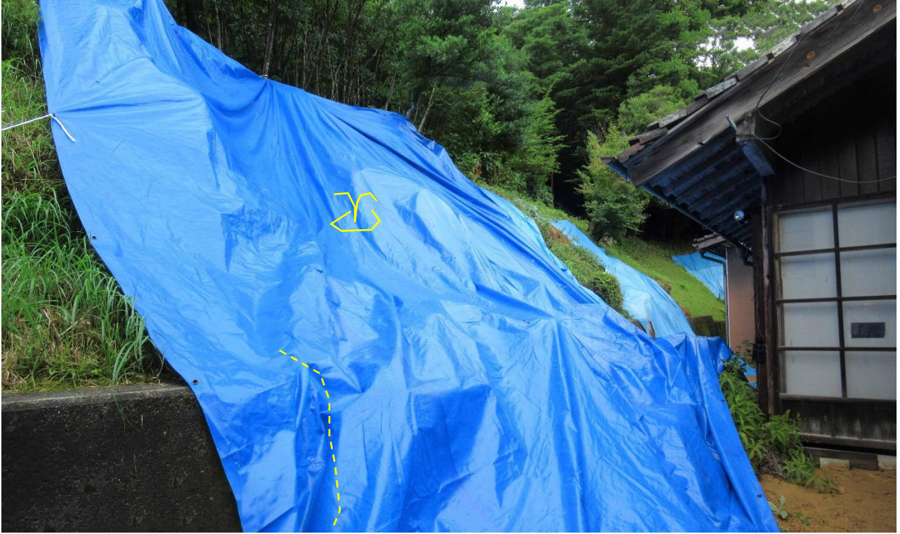
⑥ 中央付近の崩壊（鉄砲水噴出箇所）
