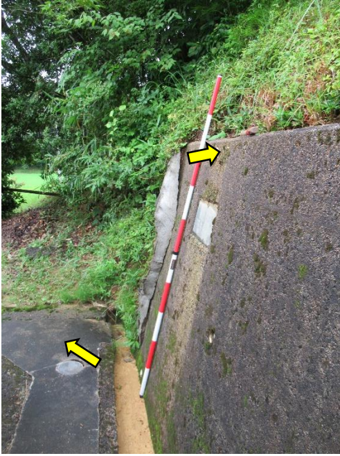
③ 既設擁壁（S45年頃施工）の変状 と宅地地盤の盛り上がり
