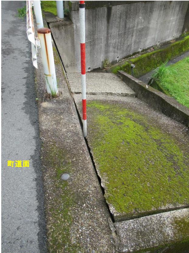
歩道面の変状
