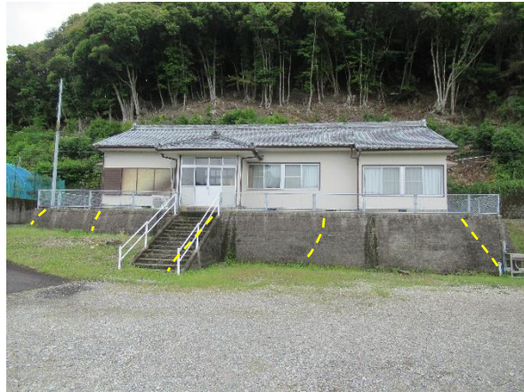
② 町道下流側家屋の変状
