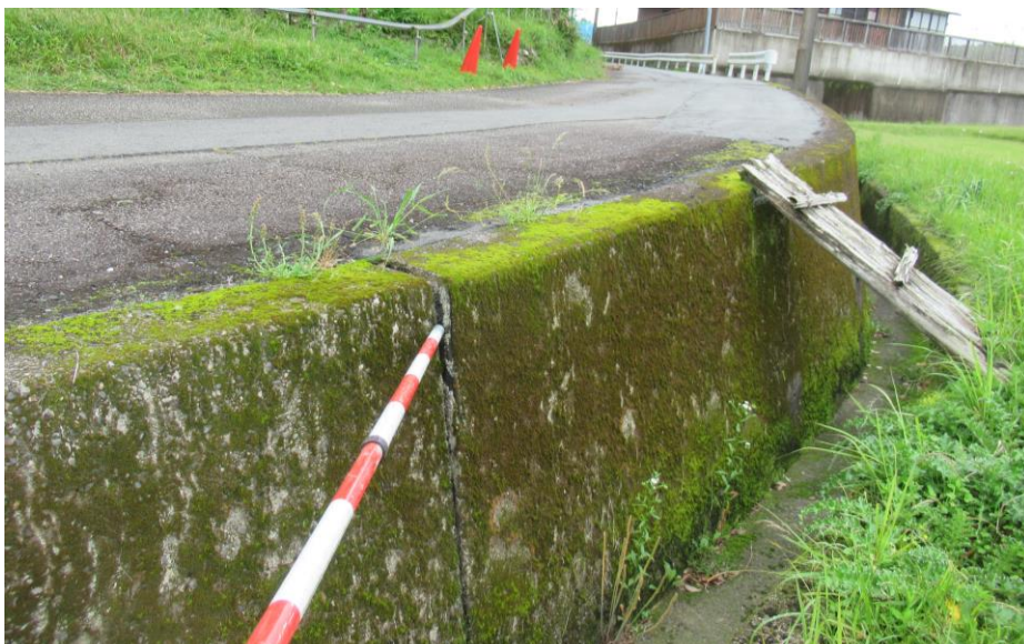
町道擁壁のズレ (この付近の水深 4m 程度以上)
